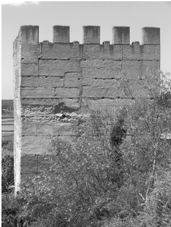
Fig. 9 – Torre de la Fortaleza almohade de Alcácer do Sal. Prácticamente toda la cara se halla cubierta por un proyectado de hormigón, con la excepción de un testigo en el que se aprecian, descarnadas, las tapias originales. Los resaltes entre los merlones son producto de una deficiente interpretación de las huellas o rastro constructivo generado en la formalización primigenia de la merlatura mediante encofrados.
