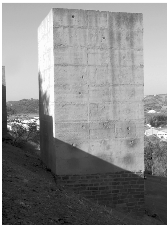
Fig. 10 – Torre albarrana del recinto almohade de Silves. Las tapias, totalmente descarnadas han sido completamente forradas por otras nuevas, sobre las que se ha tratado de reproducir la apariencia de los típicos encintados almohades, presentes en algunos lienzos de la misma fortificación.
