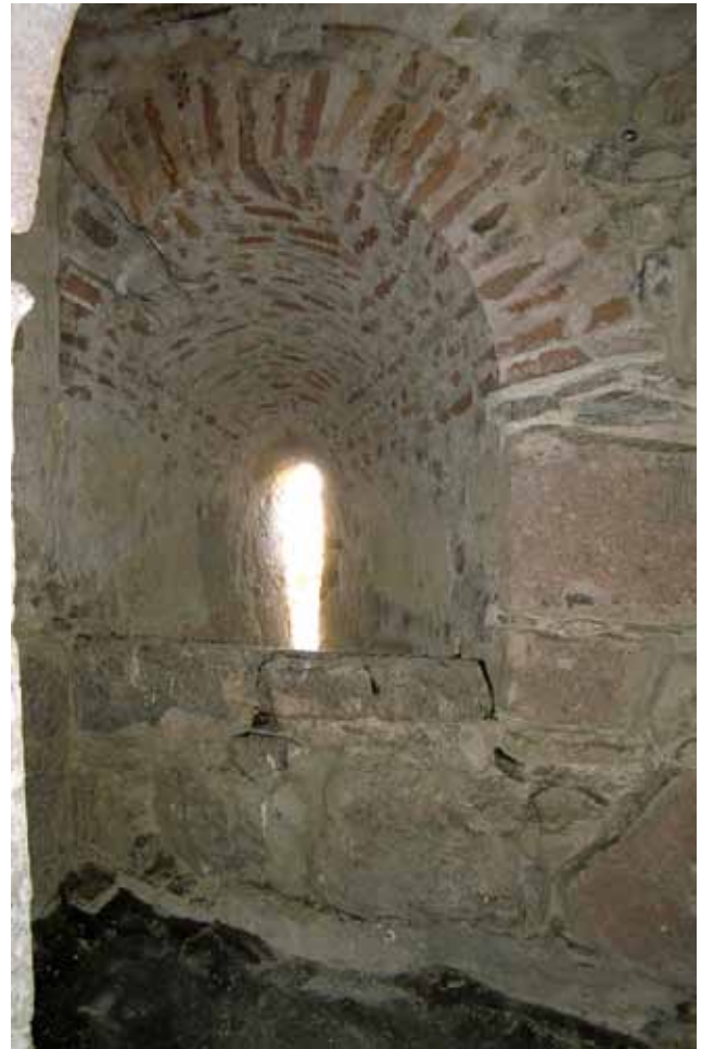
Detalle de una de las aspilleras de la Torre Blanca abovedada con fábrica de ladrillo.
