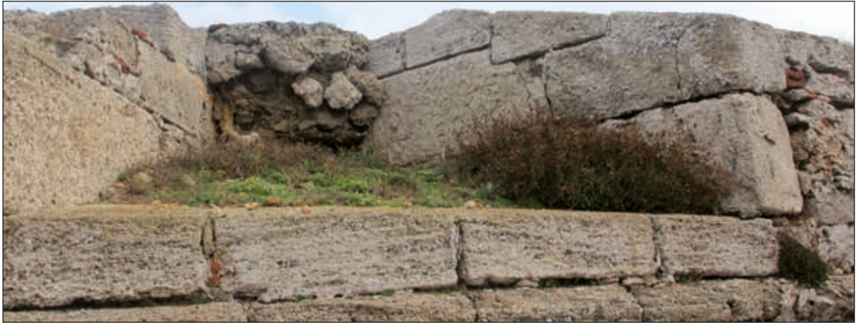
Lámina 8. Detalle de la construcción de las troneras con inclusión de sillares engatillados. Imagen de Ángel Sáez
